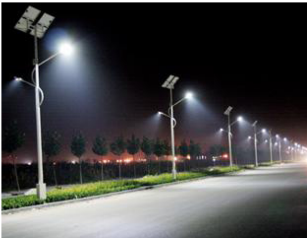
Image 7 : Ce lampadaire solaire éclaire le réseau viaire et la voie de circulation dédiée aux piétons. (Source : ledosaure.fr)
