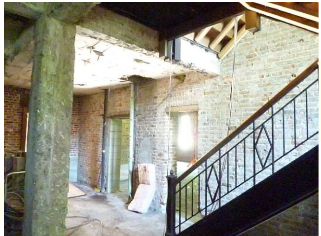
L'escalier ornemental, élément architectural important, sera mis en valeur lors de la rénovation de la future Maison du citoyen.
