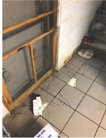
Photo B : Fissure dans la céramique
