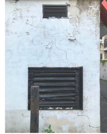
Photo F : Lézarde dans le mur de bloc
