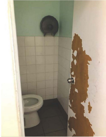
Photo A : Fini de la porte en piètre état
