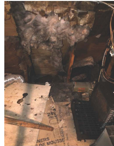
Photo G : Ferme de toit affecté par la matière fongique
