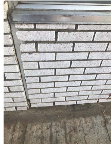
Photo H : Fissure près de l'ouverture
