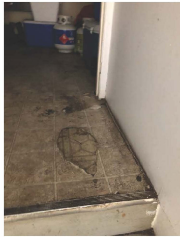
Photo D : Finis de plancher en piètre état
