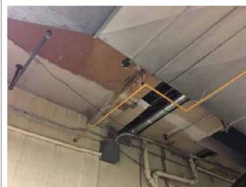
Rez-de-chaussée | Entrepôt De nombreux cernes d'eau sont observés au plafond en gypse.
