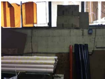
Rez-de-chaussée | Entrepôt Au mur gauche, des coulisses d'eau sont observées, suggérant des infiltrations ou un problème de condensation.
