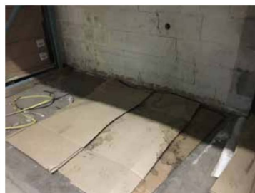
Rez-de-chaussée | Entrepôt À certains endroits, des cartons touchés par l'humidité et la moisissure jonchent le sol.
