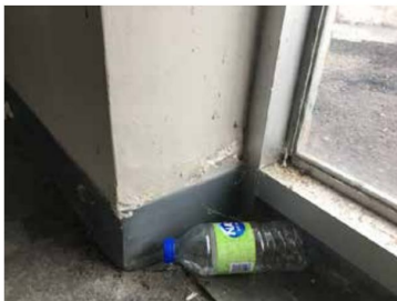
Rez-de-chaussée | Cage d'escalier, section bureaux Mur en gypse effrité par l'humidité.
