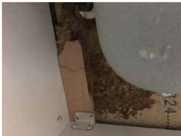
Rez-de-chaussée | Cuisine Cernes d'eau visibles sur le bois pressé sous le comptoir.
